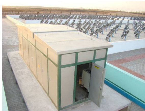
中国首座太阳能聚光光伏示范站--伊泰变电站
