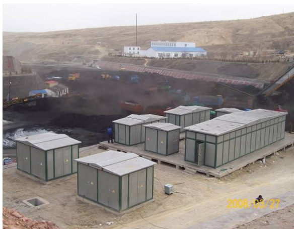
神华集团金通煤矿 10kV 开闭所
