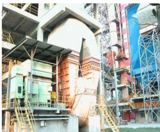
华新水泥日产 5000 吨干法水泥线原料磨风机
