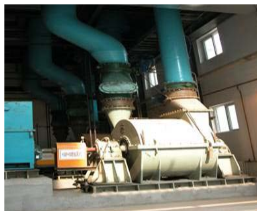
秦皇岛热电厂高压流化风机
