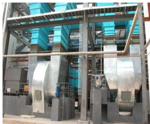
秦皇岛热电厂循环流化床一、二次风机
