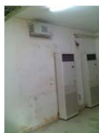
室内出风装置
