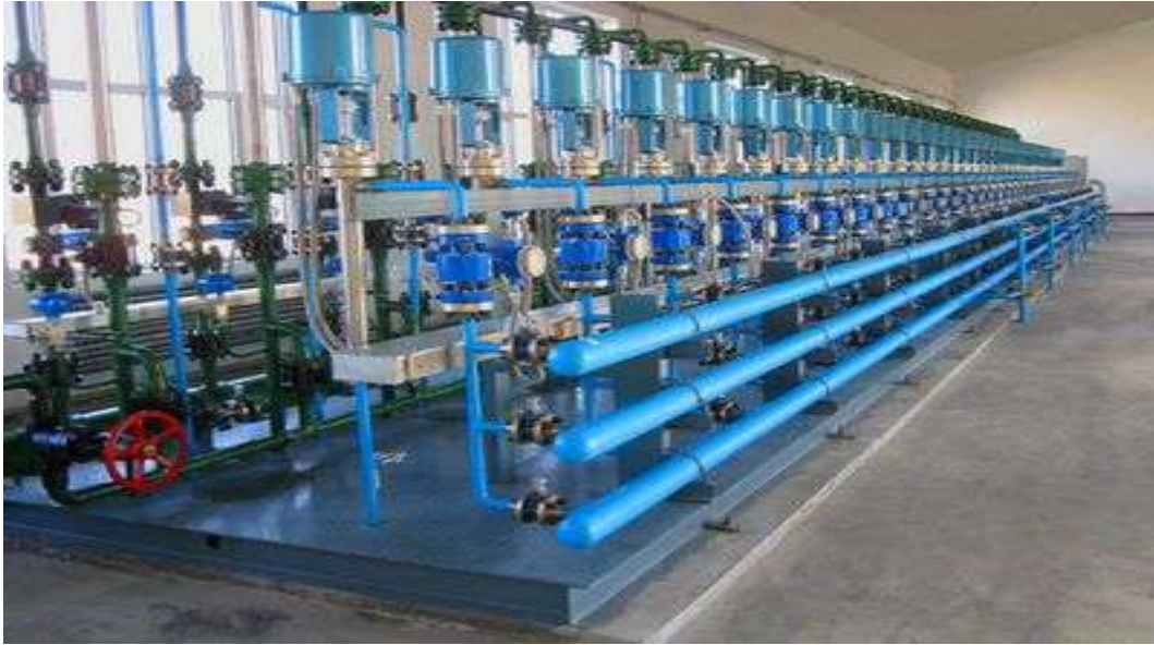
图：橇装式聚合物注入站（为中石油大庆油田提供的装备）
