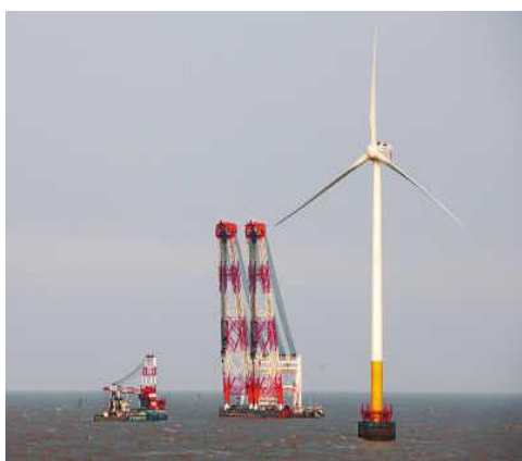
东海大桥海上风电场
