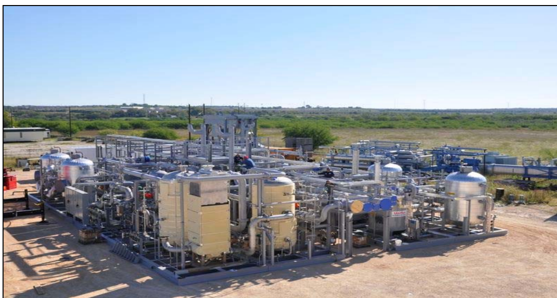
上图为天然气液化撬装设备
