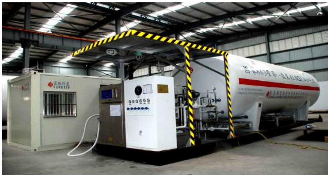
上图为 LNG 汽车撬装加气站
