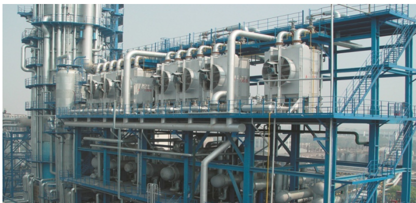
10 台板式空冷器应用于兰州石化公司 500 万吨/年常减压蒸馏装置中
