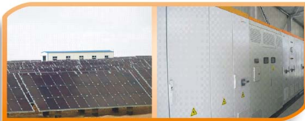
青海格尔木光伏并网电站
