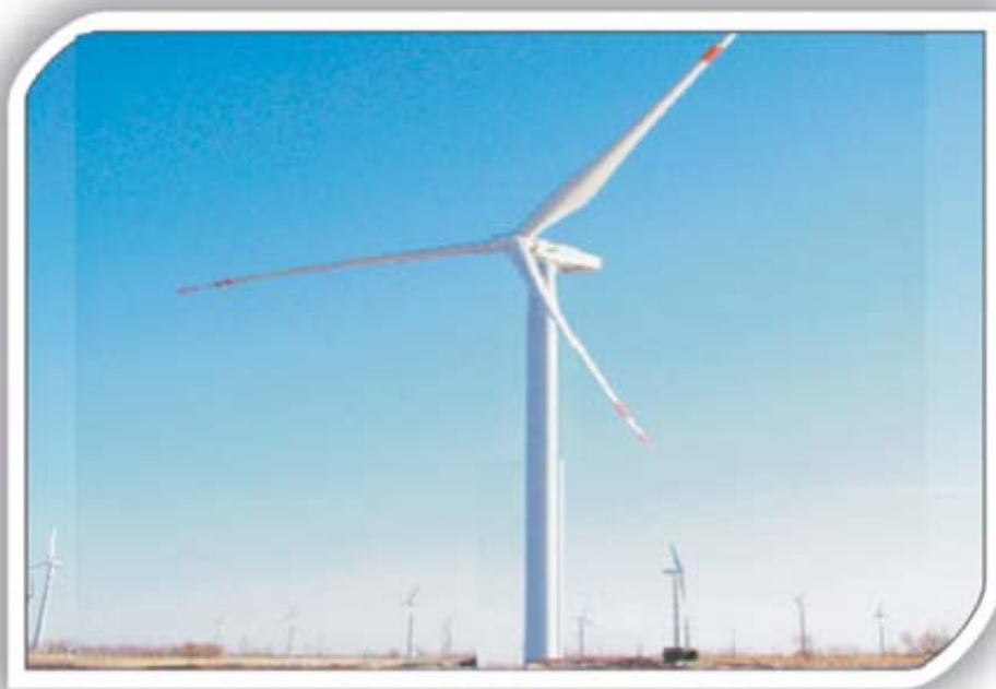
内蒙古通辽风电项目
