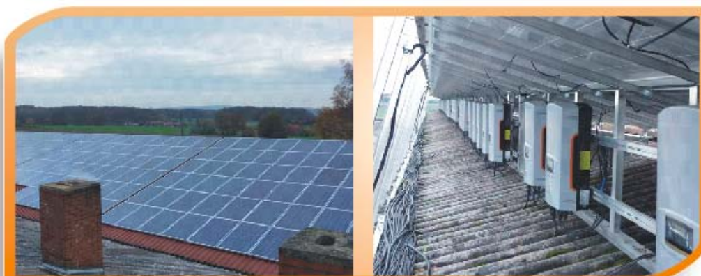
德国Melle roof光伏项目
