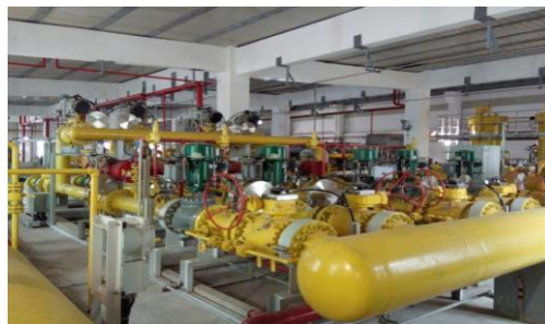
调压站（天津陈塘庄燃气电厂）
