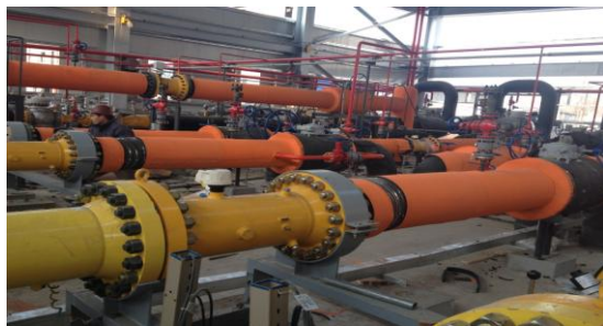
调压站（大唐北京高井热电厂）
