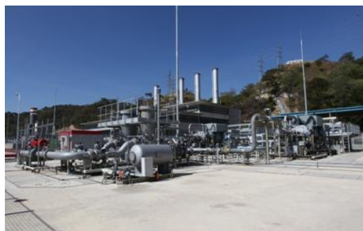
增压站（委内瑞拉新卡夫雷拉燃气电厂）
