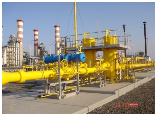
调压站（阿联酋特维拉联合循环电厂）
