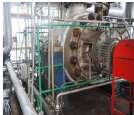
中石化广东湛江东兴石化液相柴油加氢装置主循环泵
