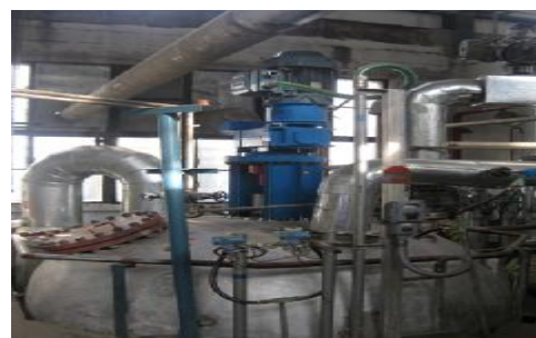
中国石油大庆石化分公司化工三厂 SAN 装置 A101 搅拌釜
