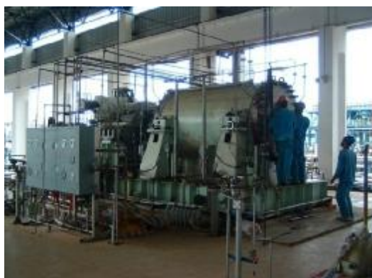
中国石化海南炼化有限公司循环氢压缩机
