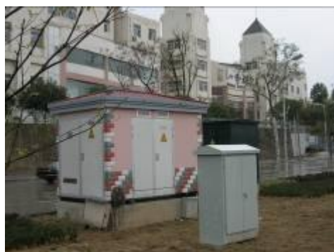
用于房地产小区的箱式变电站
