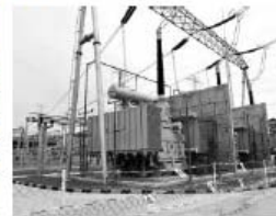
南网深圳交椅变电站
