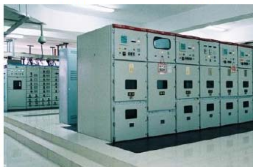
配电房实物图
