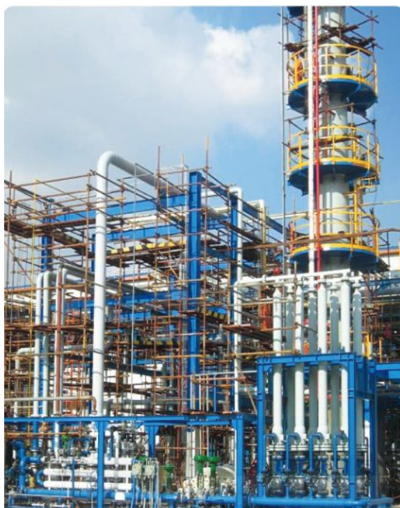
中国石油天然气股份有限公司哈尔滨销售分公司 8000Nm 3 /h 瓦斯气膜法氢回收装置
