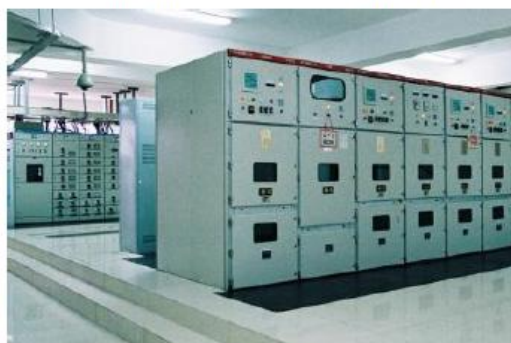
配电房实物图
