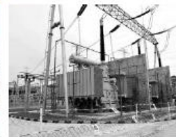
南网深圳交椅变电站
