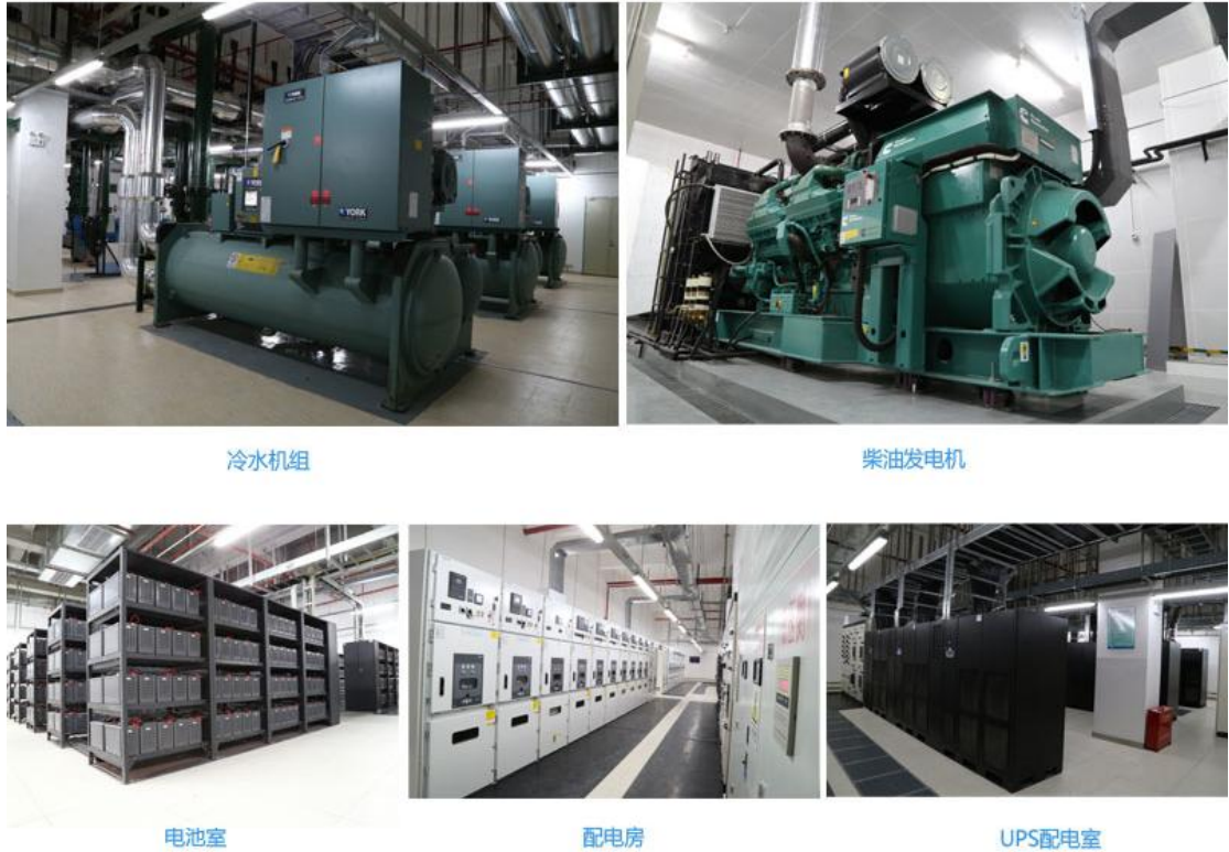
图 1：盘古数据中心机房及相关设备
