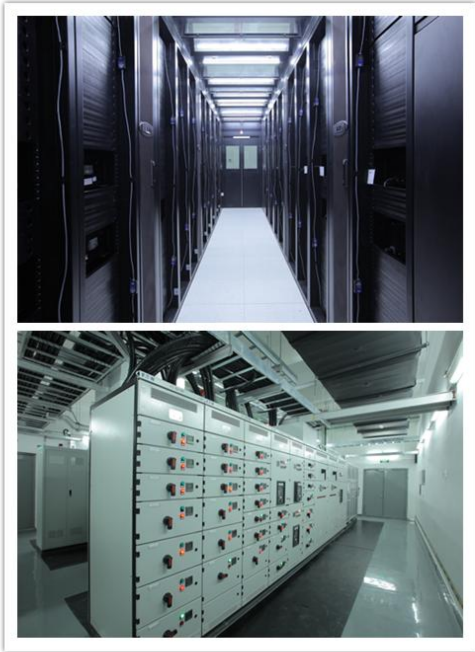
图 8：9 号数据中心机房
