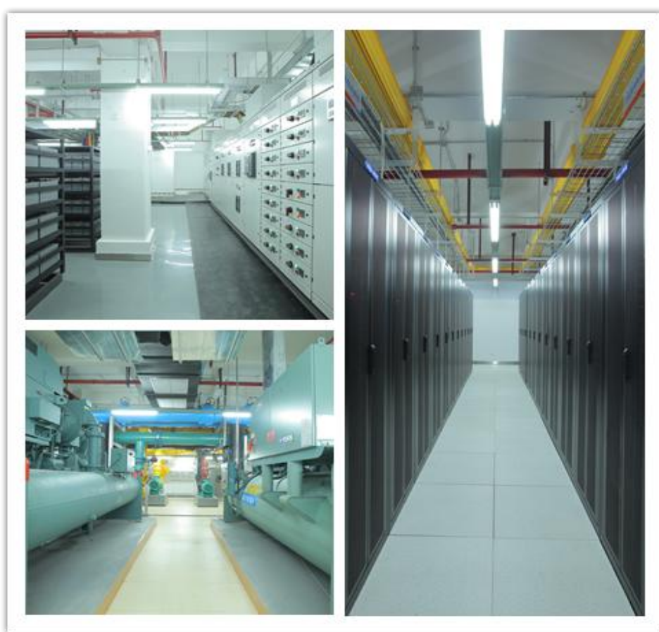
图 7：9 号互联网数据中心机房及设备
