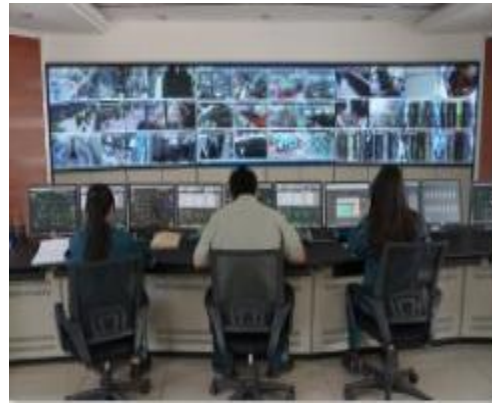
管道远程控制中心
