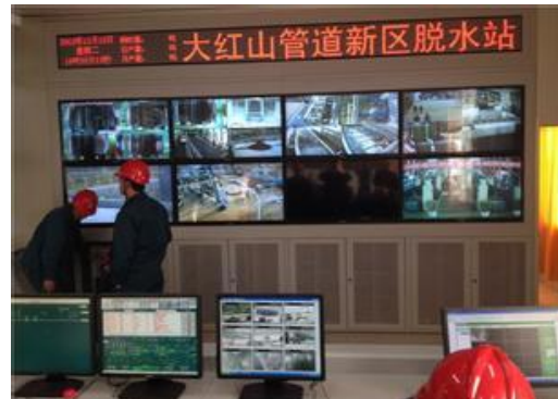
脱水站远程控制室
