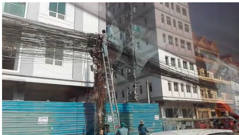
图 2-26 金边市区混乱的电线
