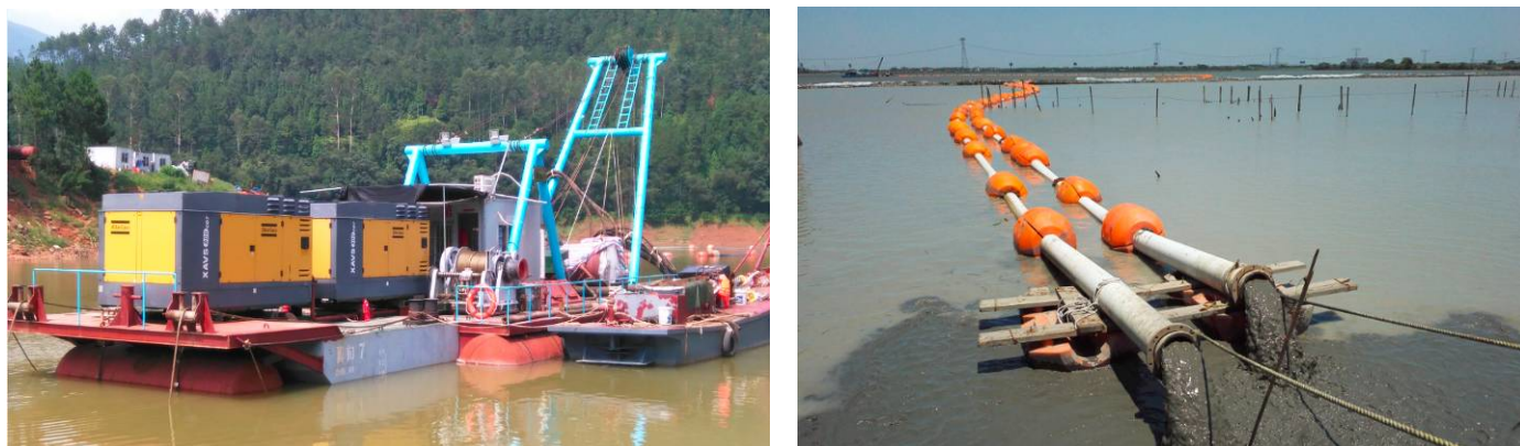
泵吸式生产现场作业图
