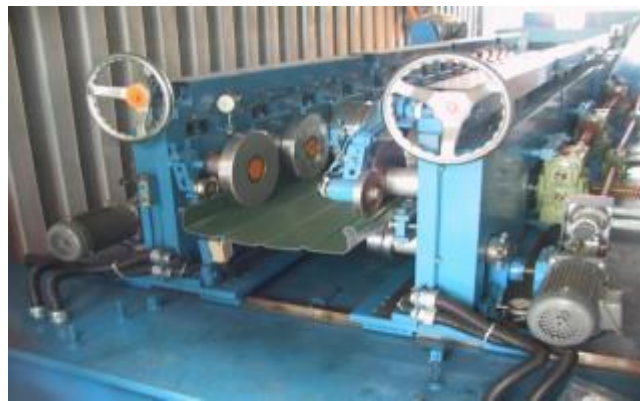
现场生产出料口
