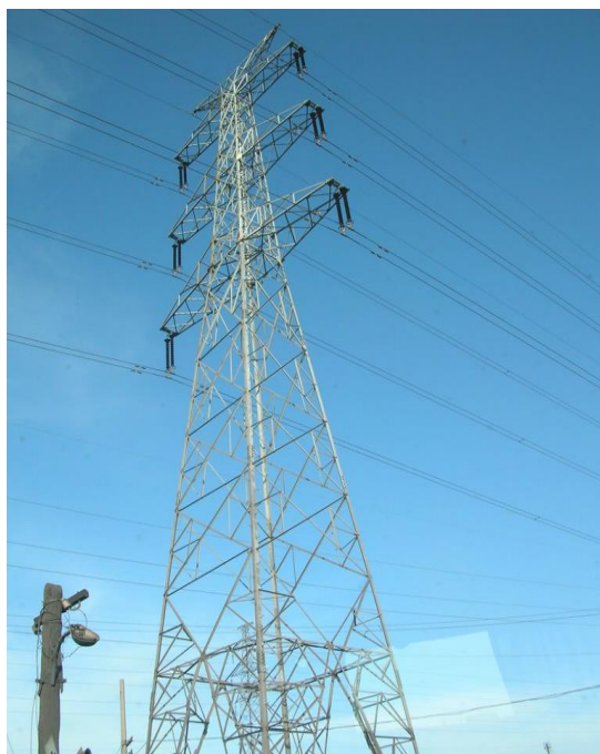
输电线路角钢塔
