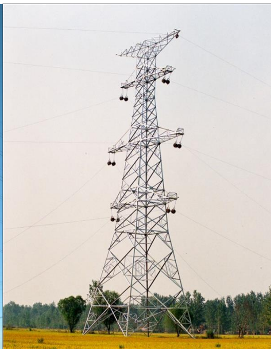
输电线路角钢塔
