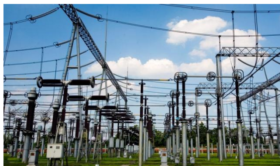
电力电网设备
