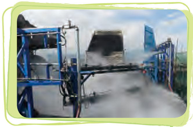
破碎站防风抑尘网和干雾抑尘装置
