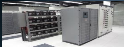
持续供冷电源模块
