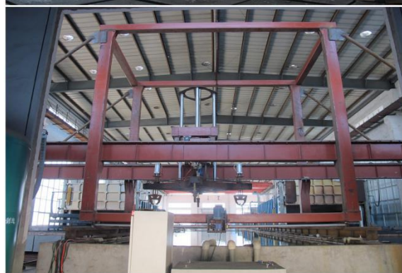
热处理自动化流水线已安装调试
