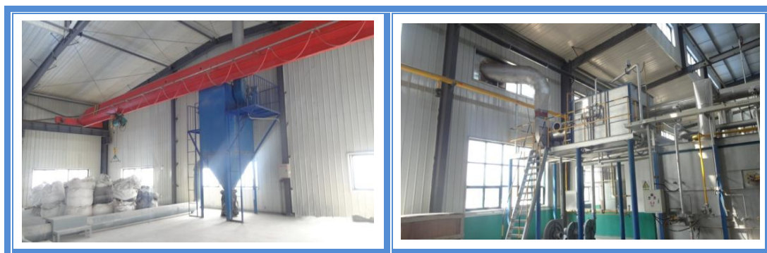
图 5-3 除尘粉收集窑炉余热综合利用
