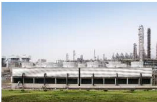
中国石油四川石化有限责任公司（四川·彭州） 39 台 NH-5000 型冷却塔
