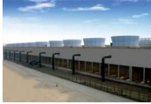
中国石油天然气股份有限公司兰州石化分公司 （甘肃·兰州） 13 台 NH-5000 型冷却塔
