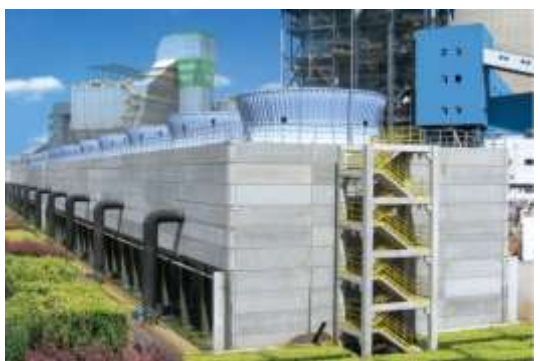
巴西 CANDIOTA 电厂 1×350MW 燃煤电站 10 台 NH-4508 型冷却塔
