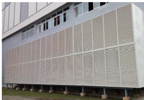
➤ 东莞中电新能源热电厂配套消声装备。
