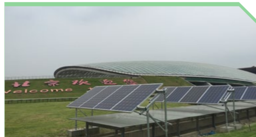
首都機場三號航站樓停車場樓頂太陽能發電設施
