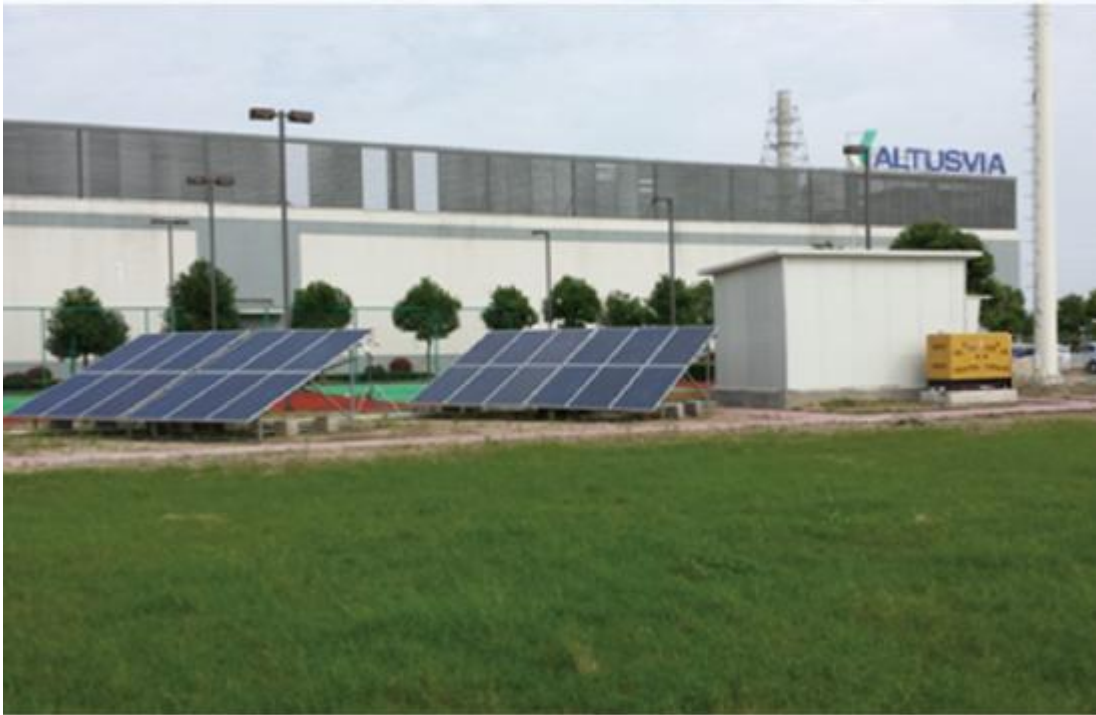
图：公司混合能源产品应用于中国电信太仓通信基站
