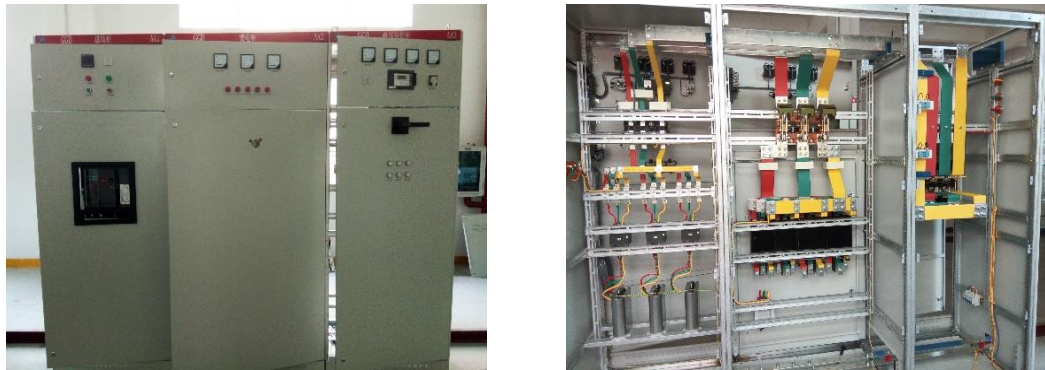
低压配电柜外观图
