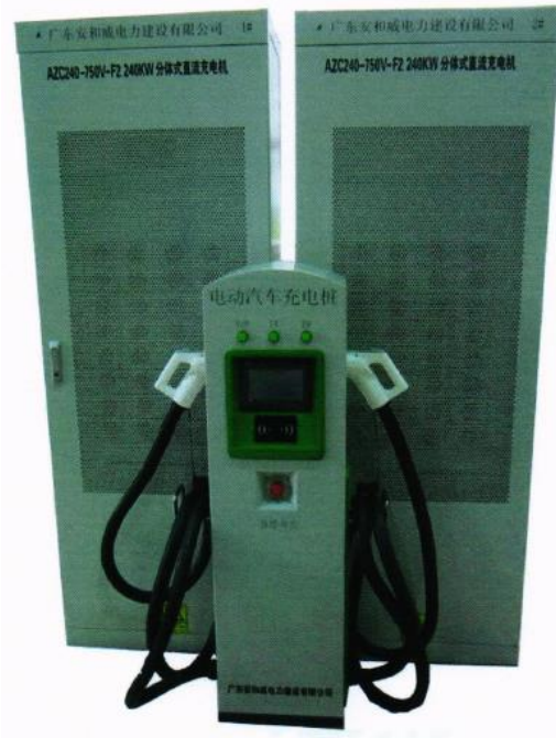
240KW 直流式充电桩外观图
