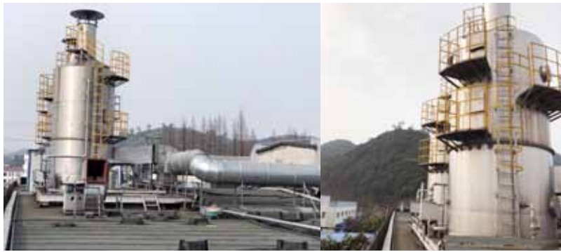
Vulcanised exhaust gas treatment equipment of ASIMCO NVH Technologies Co. Ltd. (Anhui) 亞新科噪聲與振動技術(安徽)有限公司硫化廢氣處理設備
