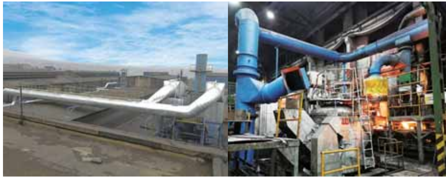
Dust removal equipment of ASIMCO International Casting Co., Ltd. (Shanxi) 亞新科國際鑄造(山西)有限公司除塵設備
