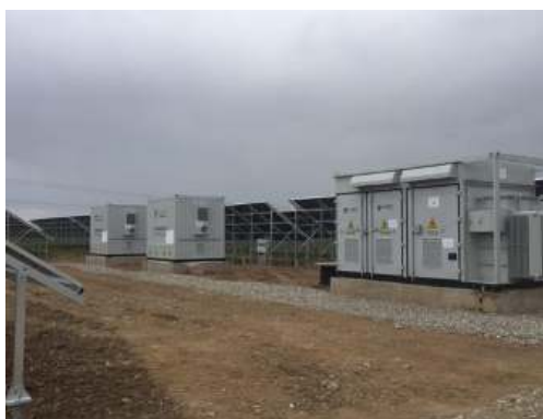
国电投黄河水电青海共和 3MW 光储示范项目
