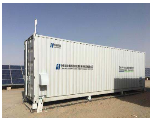
华能青海格尔木一期储能示范项目
