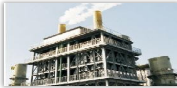
废气处理设施
