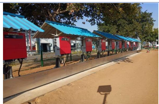
博世 4MW 项目
