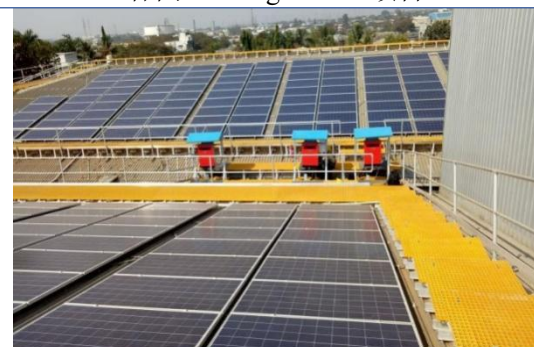
西门子 5MW 项目
