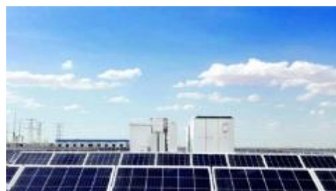
新能源电源管控设备
