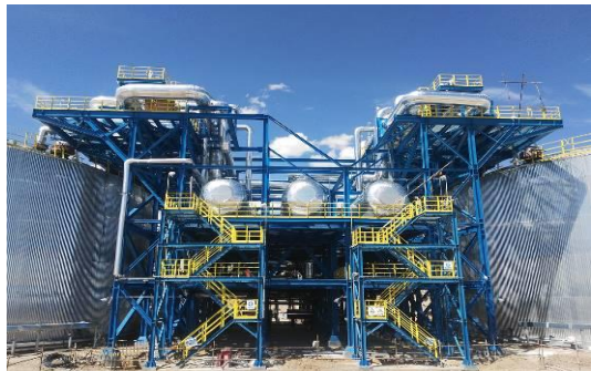
德令哈光热发电厂—油盐换热器
