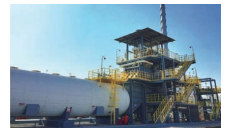
烟台某化工行业气液焚烧项目 Liquid Waste Incineration System, Chemical Industry, Yantai
