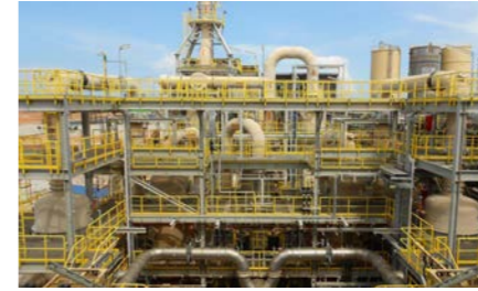
马来西亚某稀土加工烟气脱硫项目 Rare Earth Processing Flue Gas Desulfurization Project in Malaysia
