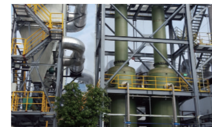
福建某化工行业废气处理系统 SNCR and Flue Gas Treatment, Chemical Industry, Fujian
