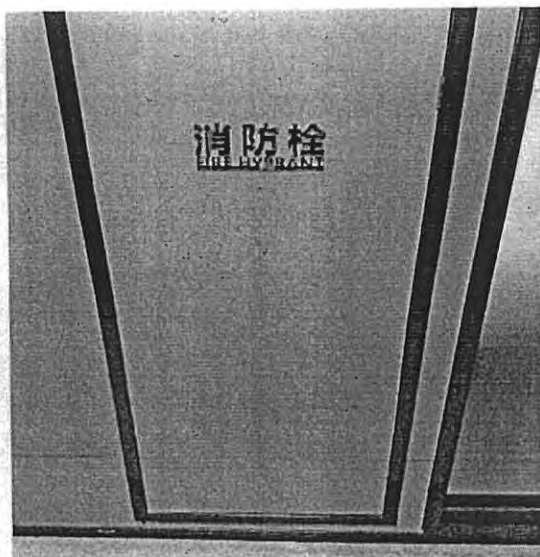
图 3-2-2 消防栓箱及灭火器外观正常
