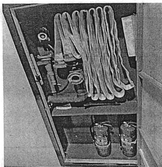
图 3-2-3 室内消防栓箱配件齐全
