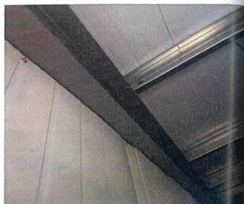
照片 9.3.6 檩条完好未见变形
