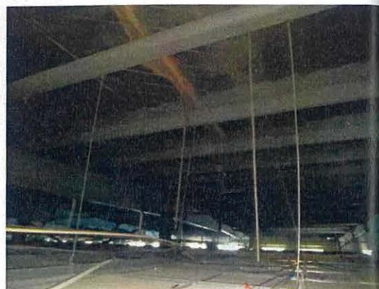
照片 9.3.6 檩条完好未见变形
