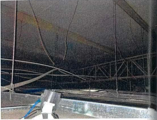
照片 9.3.6 檩条完好未见变形
