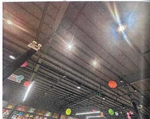
照片 9.3.6 檩条完好未见变形
