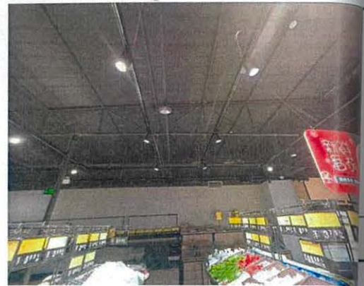
照片 9.3.6 檩条完好未见变形
