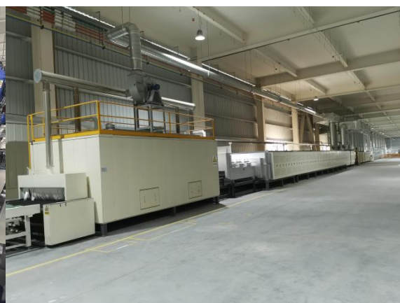
NOCOLOK 钎焊炉钎焊
