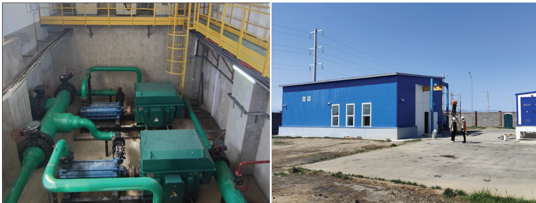
圖8.3：一級及二級增壓泵站
