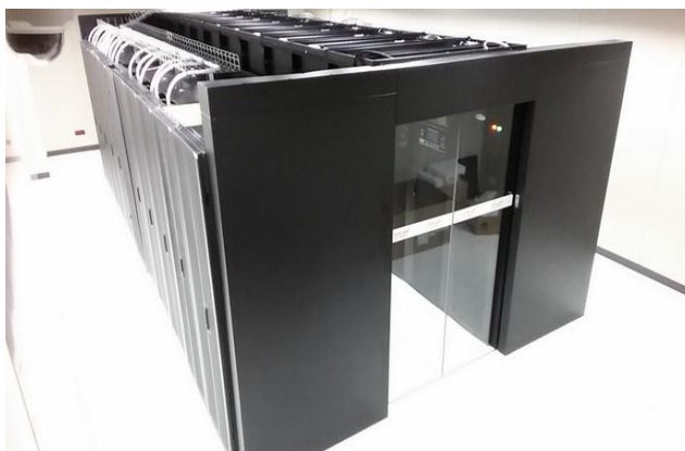
图 31: “慧云”模块化数据中心
