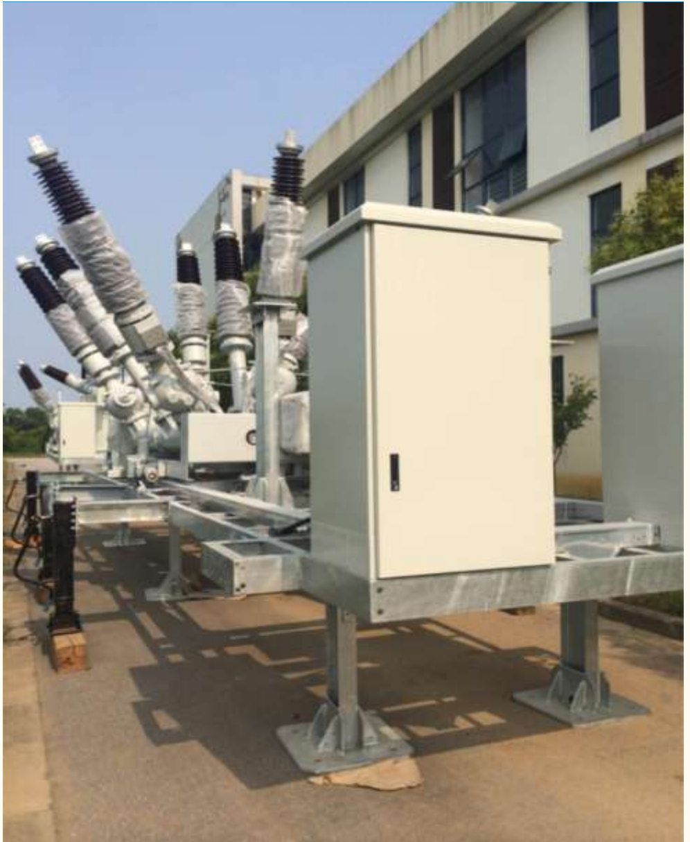
图表 8：金智科技模块化变电站
