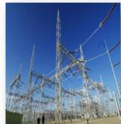
张山营110千伏输变电工程全国 首条测温、双回路OPPC线路
