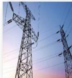
110kV濮阳曹楼输变电工程-全国 首条110kV电压等级OPPC线路
