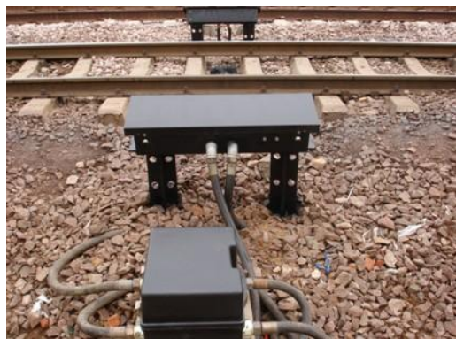
图 3:列车运行故障动态图像检测系统 (TFDS)
