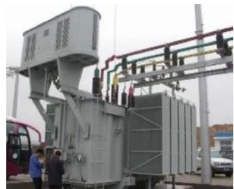
110kV 电力变压器
