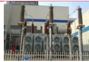
日照钢铁输变电项目
