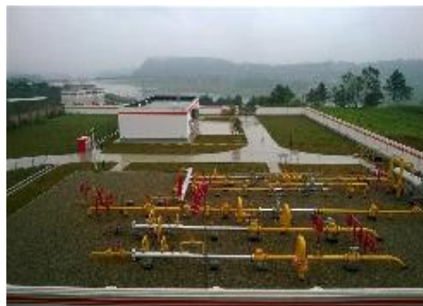
阆中工业园区配气站
