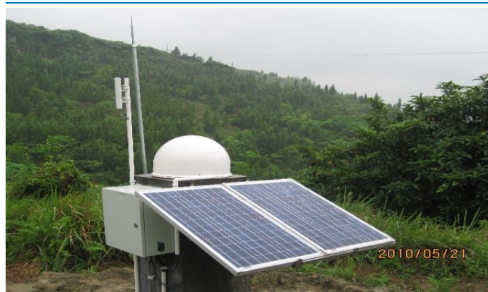
图 47 : 华测某项目太阳能供电系统
