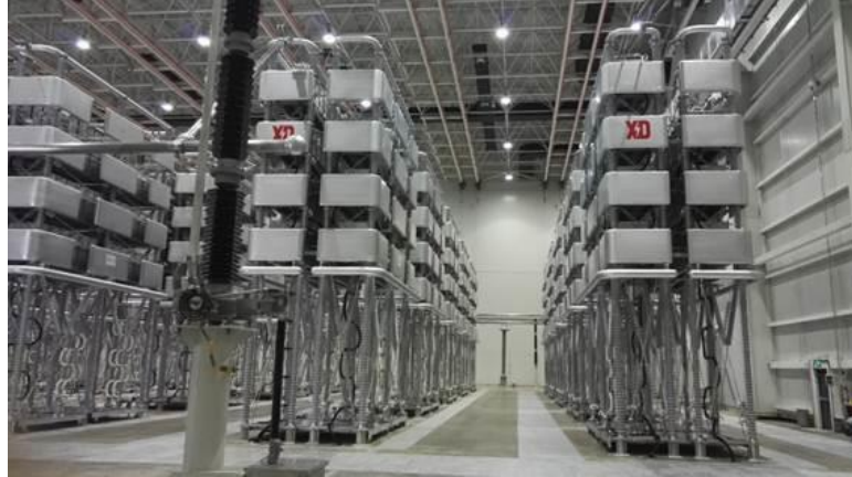
图 91：柔性直流输电工程——换流阀塔
