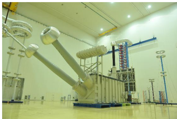
图 92：柔性直流输电工程——换流变压器
